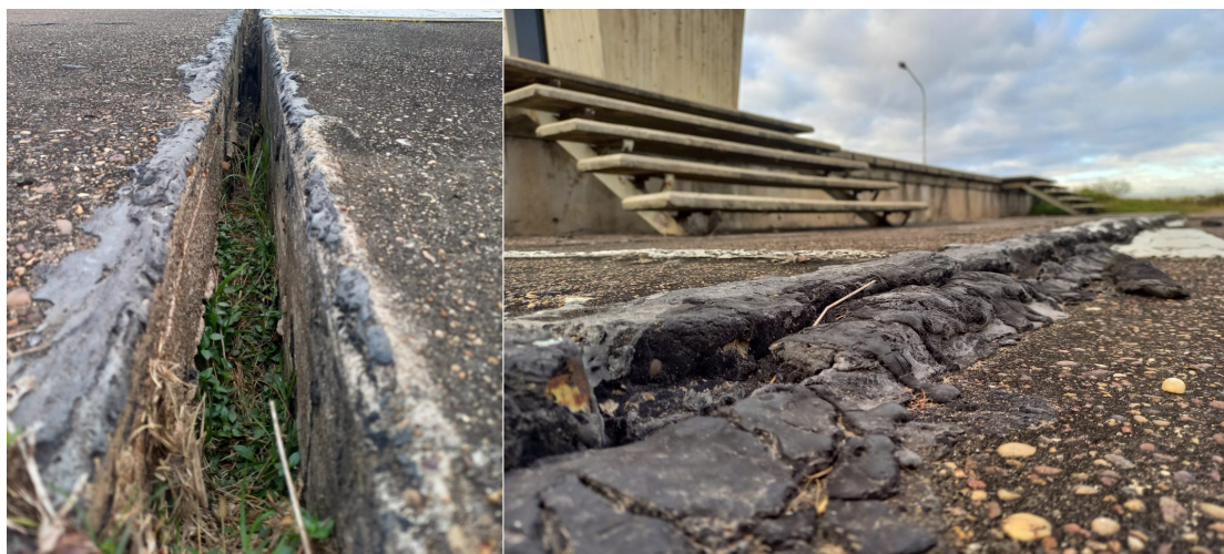
Ilustración 3: Apertura de junta y desnivel de vereda-calzada
